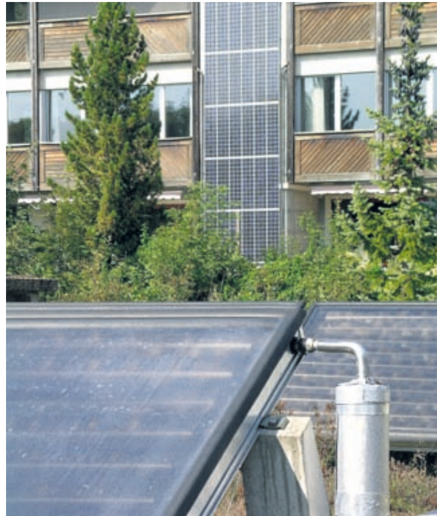
20 Jahre alte Sonnenkollektoren (Vordergrund); Photovoltaik-Panels (Hintergrund).
